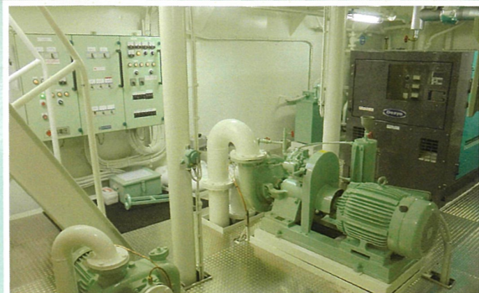
給水バージ 給水ポンプ
