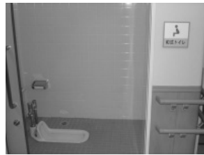
和式トイレも含め、色々な タイプのトイレを設置
